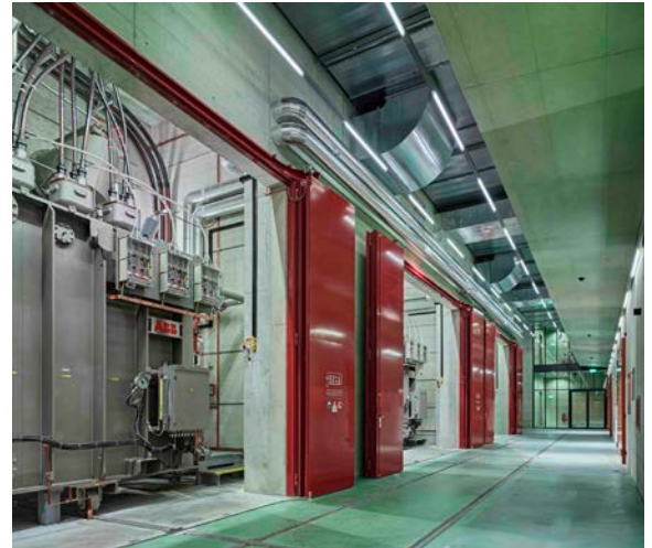
((Datei: illiz_UNTERWERK_i04_frei)) Das Unterwerk besteht aus einer 22 kV-Anlage, 50-MVA-Trafos und der 150-kV-Hochspannungsschaltanlage. Foto: Roger Frei, Zürich
