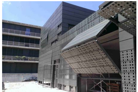
((Datei: Unterwerk_WP_20150720_029)) Um die Kassetten trotz des hohen Lochanteils zu stabilisieren, sind auf der Rückseite Quer-Verstrebungen eingeklebt worden. Foto: illiz Architektur
