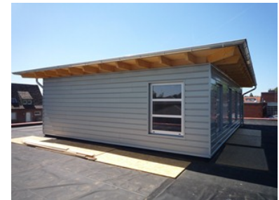
((Datei: Feuerwehr Duelmern SPLine (8).jpg)) Selbst in der Nahansicht sind die Horizontalstöße mit ihren Stoßverbindern auf der großen fensterlosen Fläche kaum zu erkennen.
