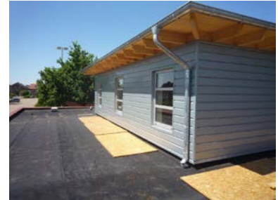
((Datei: Feuerwehr Duelmern SPLine (10).jpg)) Die horizontalen Titanzink-Paneele zeigen ein ruhiges und gleichmäßiges Verlegebild.
