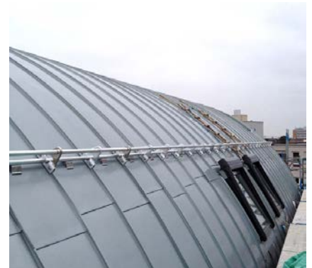
Die wegen der Länge der Schare erforderlichen Querfalze wurden sehr dezent mit zusätzlichen Haftstreifen und optisch durchlaufenden Stehfalzen ausgeführt, sodass die Ansicht der eleganten Tonnenform nicht beeinträchtigt wird. Foto: Thomas Schmidt
